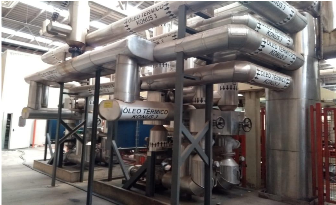
Foto 6: Sistema hidráulico de aquecimento
