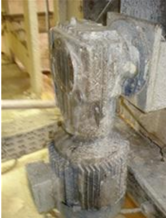
Foto 10: Motor com excesso de sujeira
