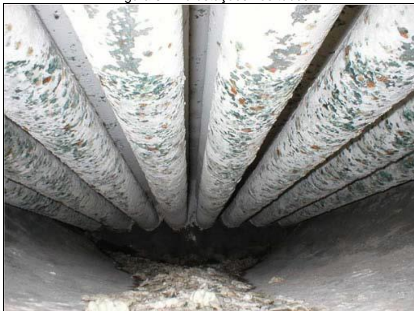
Figura 6 - Incrustações nos tubos
