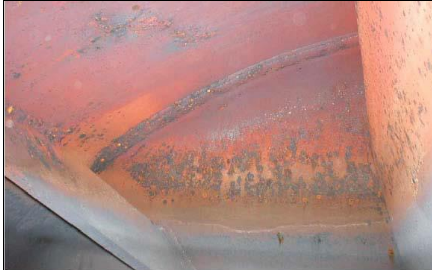
Figura 8 - Pontos de corrosão na carcaça de uma caldeira
