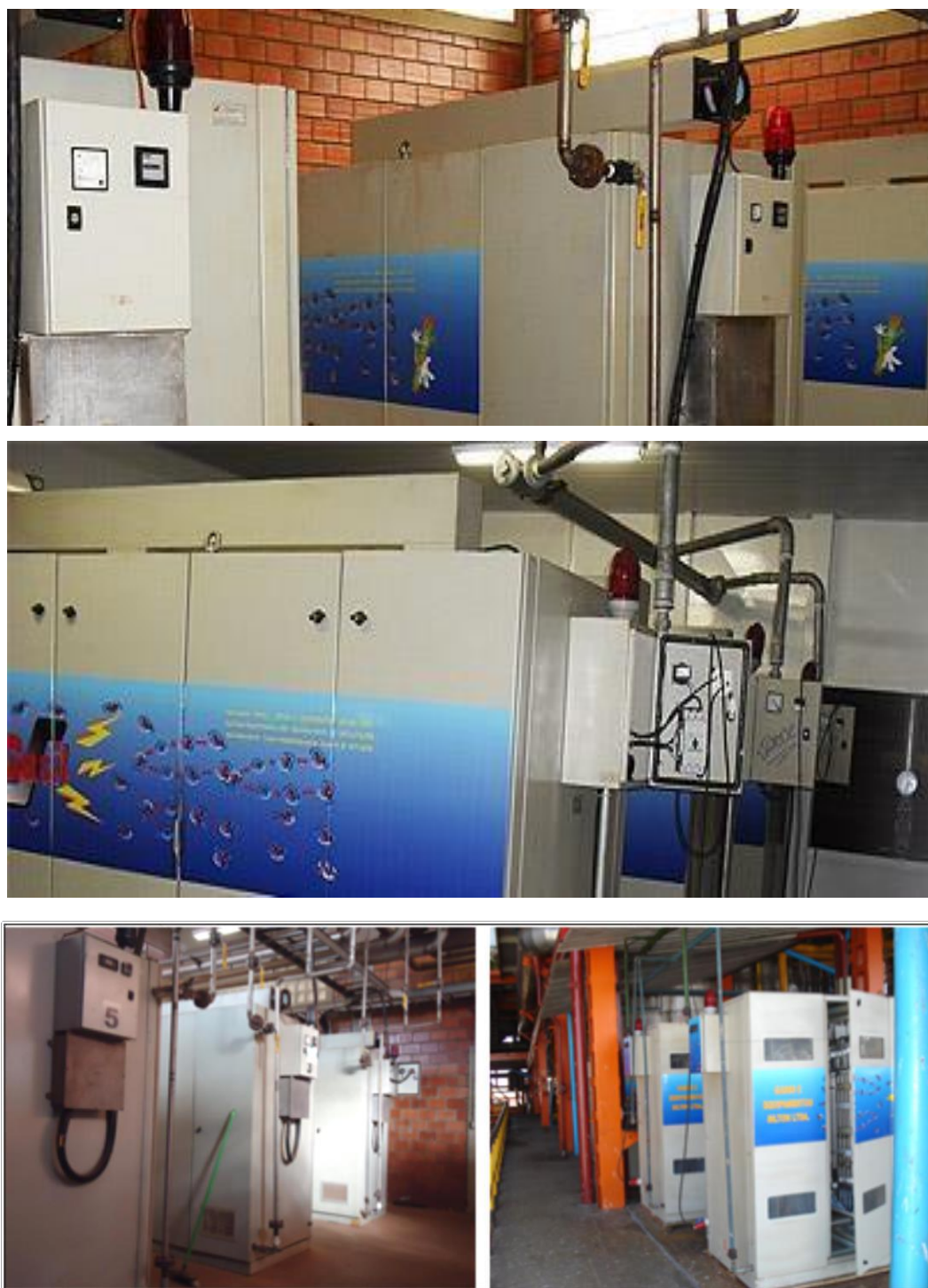
Figura 9 Sistema de geradores de ozônio.
